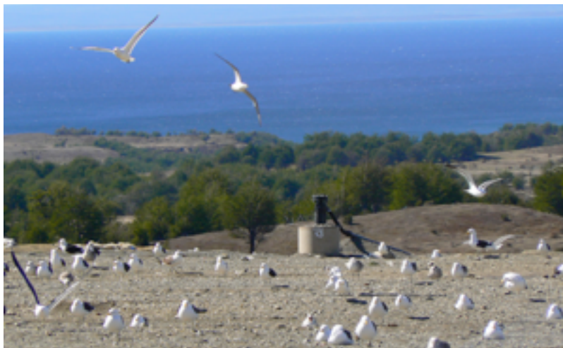
Puits de récupération de biogaz sur la décharge de Leña Dura en Patagonie Chilienne
