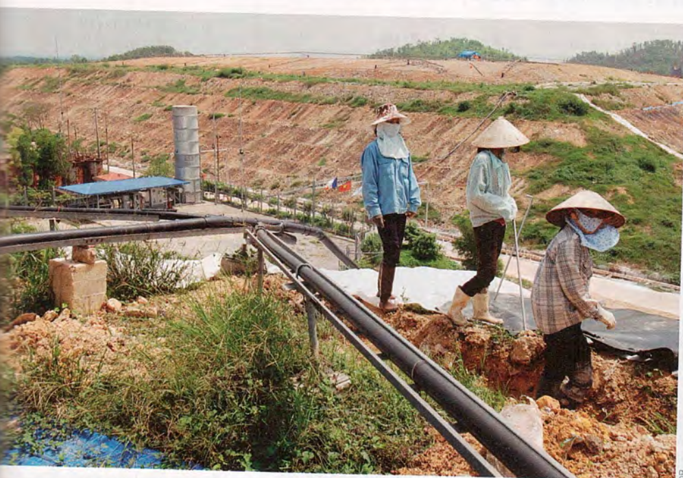
COLLECTE. Un réseau de canalisations récupère le méthane jusqu'à 25 mètres de profondeur.
